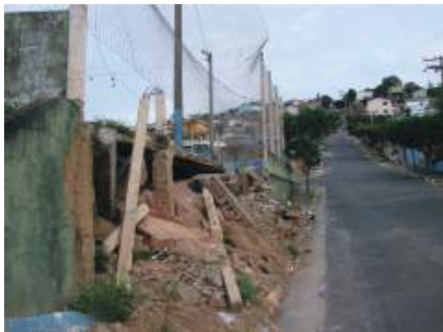
Uma tempestade destruiu a praça em 2013
